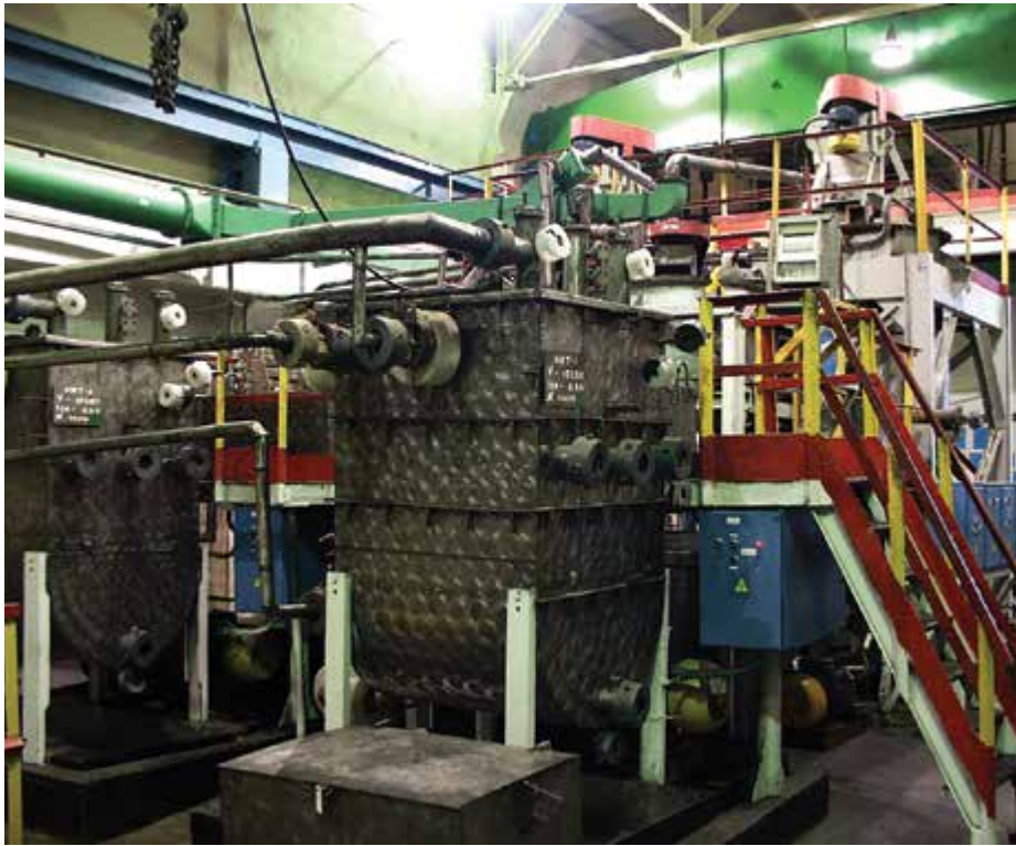
Аффинажное отделение завода по производству драгоценных металлов ТОО «Казцинк».
